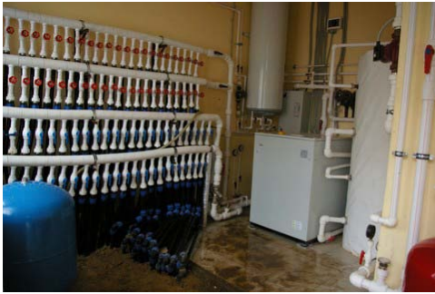
Общий вид теплового пункта в здании администрации поселка Птичное
