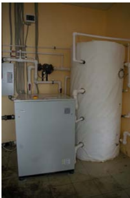
Тепловой насос и бак-аккумулятор контура напольного отопления
